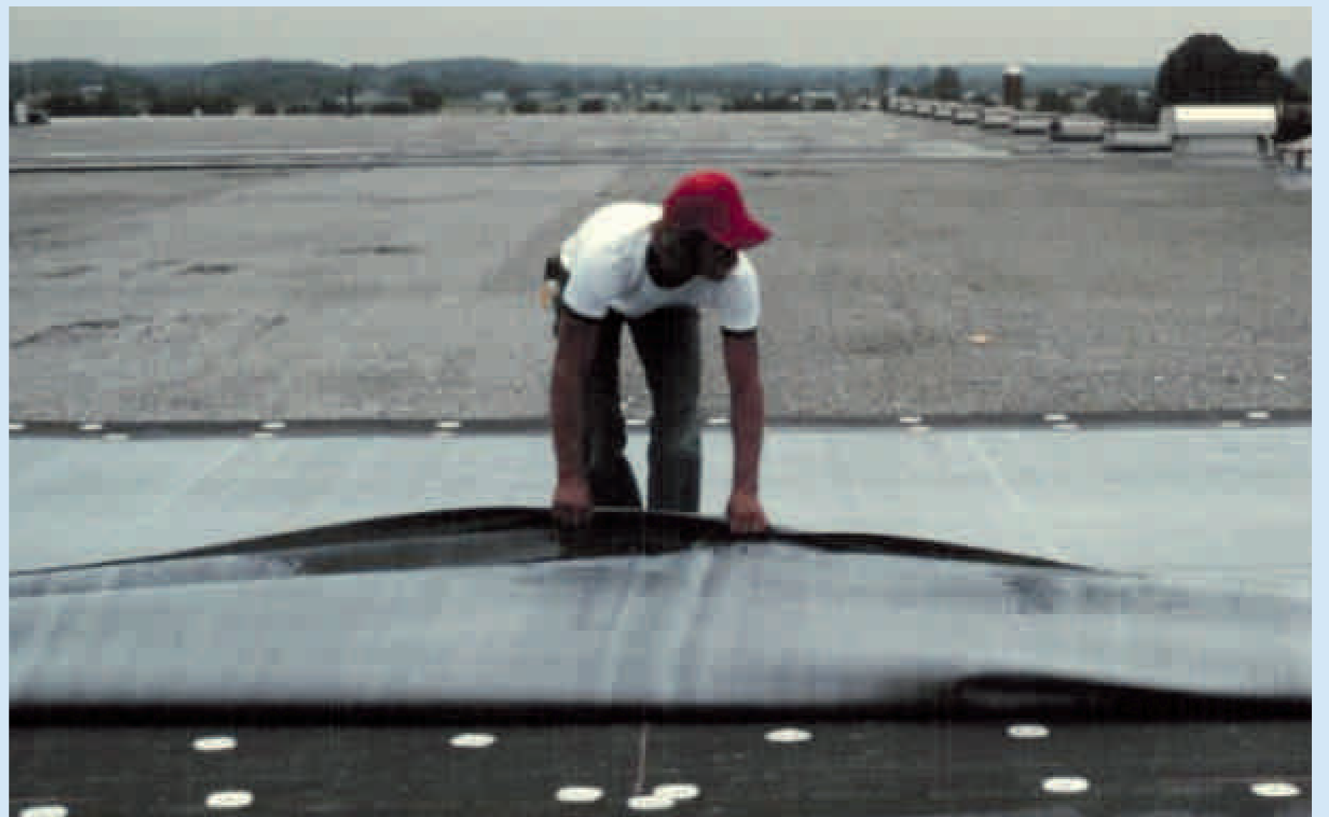
Cubierta deck adherida mecánicamente
